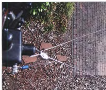
Bild 5: Die Elevated Radials für 30 m und 20 m wurden im 45°-Winkel zueinander in 2 m Höhe über dem Erdboden gespannt.
