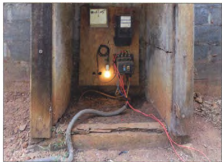
Die Verkabelung ließ Raum für Verbesserungen.
